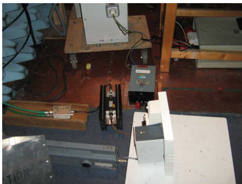
Câble sortie alarme
